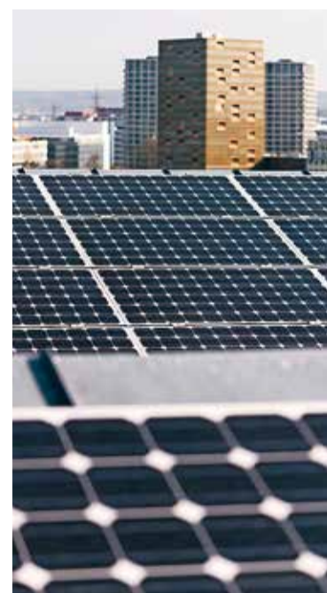
Installations photovoltaïques sur un toit zurichois. Keystone
